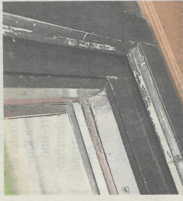
Auch die Fenster des „Reuchlin“ haben schon bessere Zeiten gesehen.
